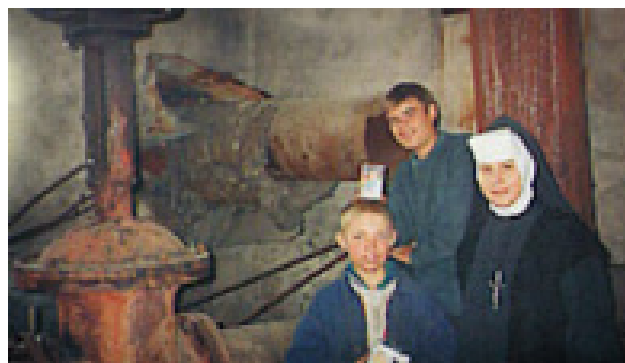
Miejska kotłownia. Wejście do rur centralnego ogrzewania. Miejsce noclegu części dzieci z projektu.
